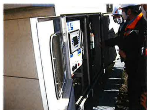
自家発電機の操作訓練実施
