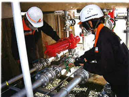
各設備の点検・作動確認
