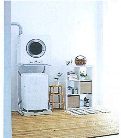
洗濯機上に専用台(高)設置
